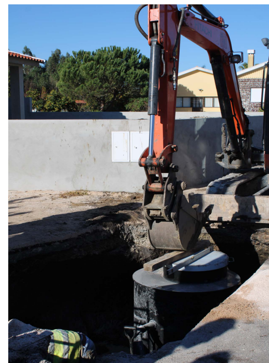
REMODELAÇÃO DAS REDES DE SANEAMENTO DE ÁGUAS RESIDUAIS E DOMÉSTICA DE VILAMAR E CORTICEIRO DE CIMA
